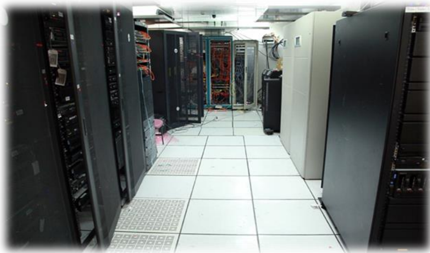
圖 2-2 機房內空間規劃不當，無法有效散熱，空間使用率也低
