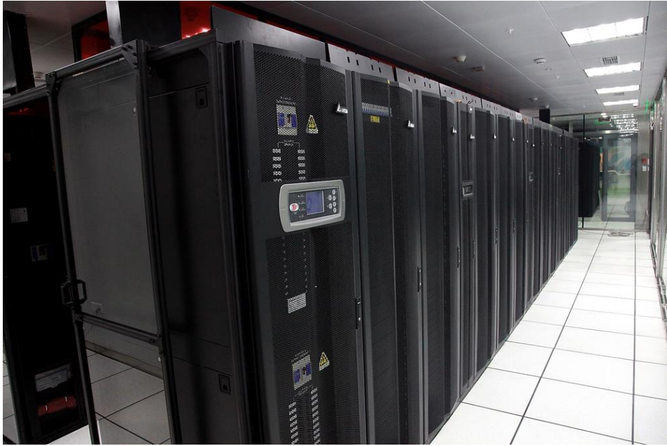
圖 3-3 伺服器機房(冷通道)
