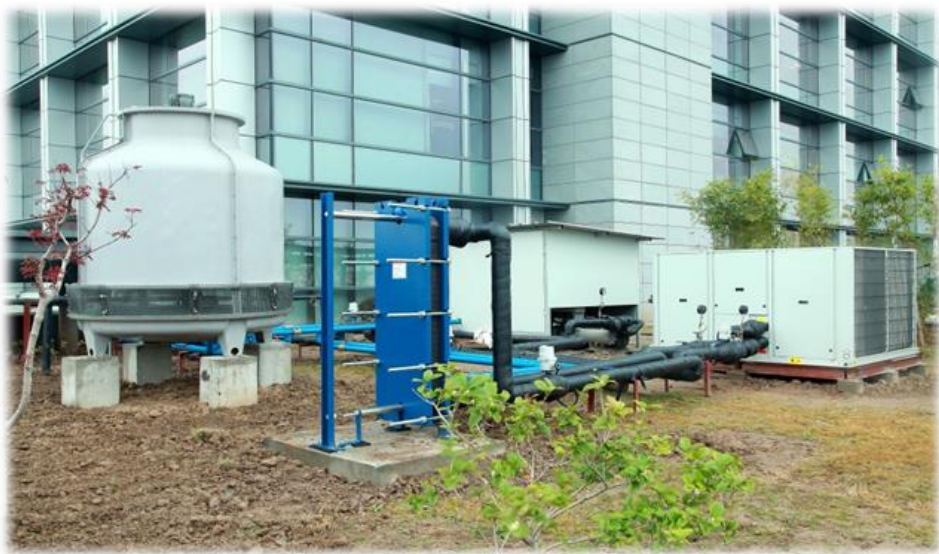
圖 3-6 室外設備配置，包括氣冷及水冷冰機及熱交換器等設備
