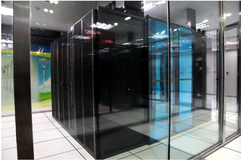
圖 3-5 網路機房(使規劃冷通道封閉)
