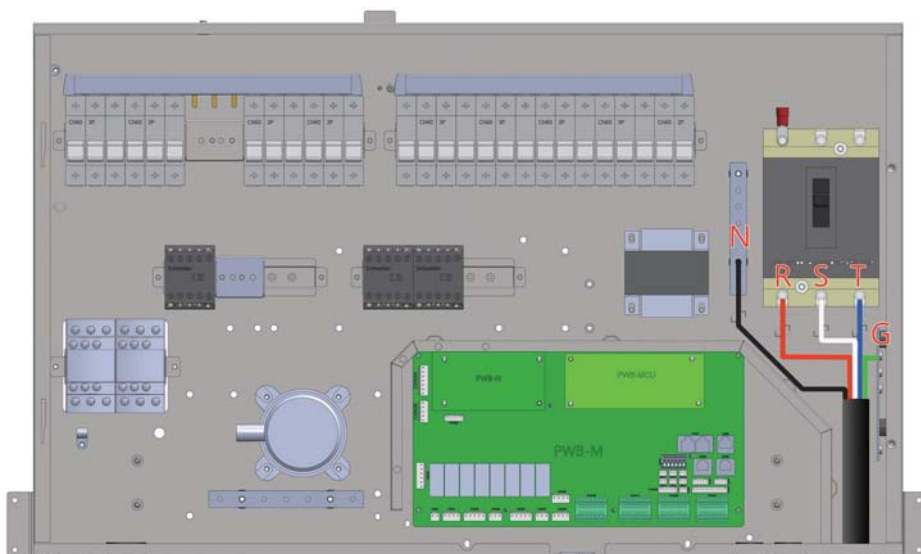
(圖 3-16：室內機電源線)
