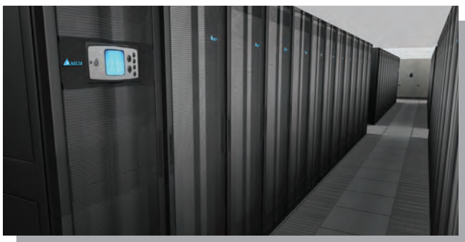
供配电及监控一体化系统 + 机柜系统 + 制冷系统
