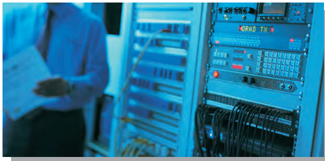
小型数据中心
